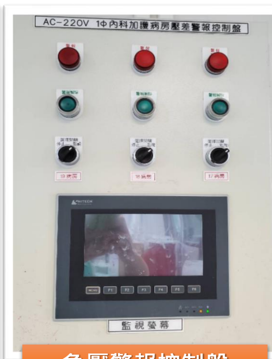
負壓警報控制盤
