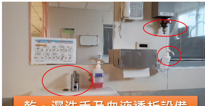
乾、濕洗手及血液透析設備
